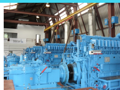
Foto: Storkmotoren in het Wakaypompge- maal na een complete rehabilitatie te heb- ben ondergaan.
