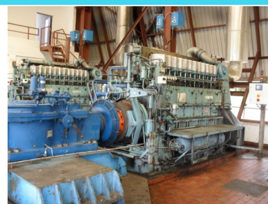
Foto: Storkmotor in het Wakaypompemaal
